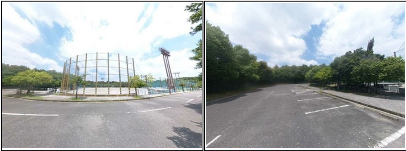
025 026 野球場バックネット 鋼製部材の腐食が著しい 野球場南駐車場 身体障害者用駐車場 1 台
