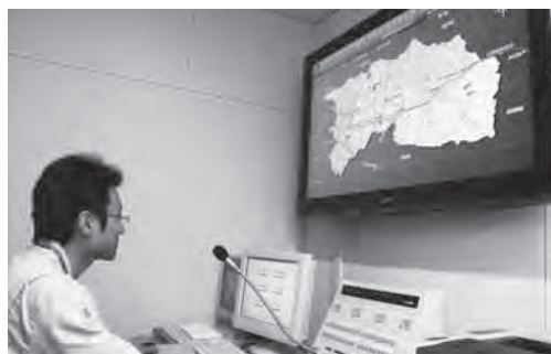
防災 行政無線 の整備
