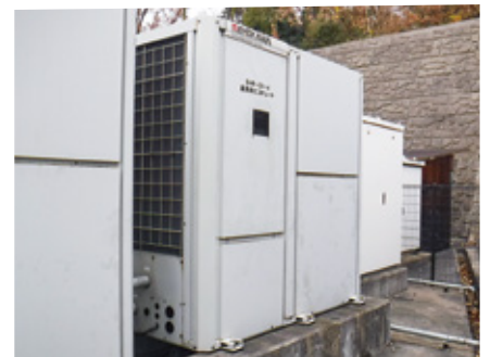
給食センターにある壊れた給湯ヒートポンプ
