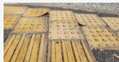
杵ヶ池通りの危険な点字ブロック
