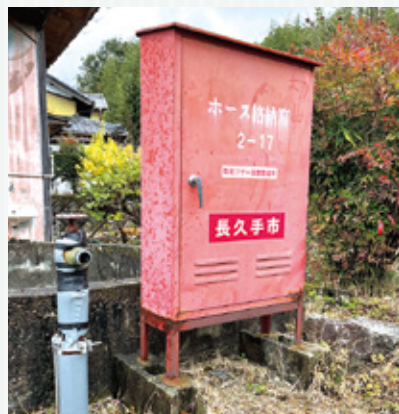
街角にある消火設備
