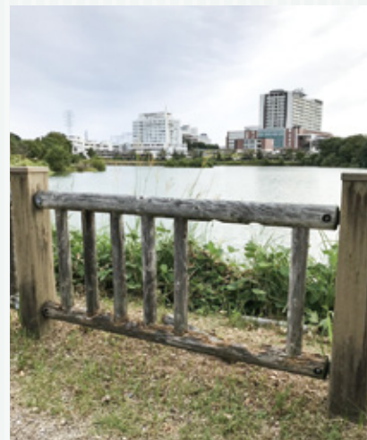
何年経っても修繕が完了しない立石池の危険な木柵
