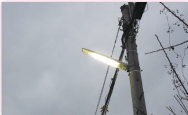
蛍光灯からLED灯への取り替えで維持費削減が期待できる
