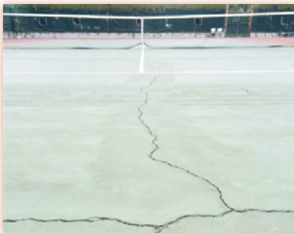
テニスコートひび割れ
