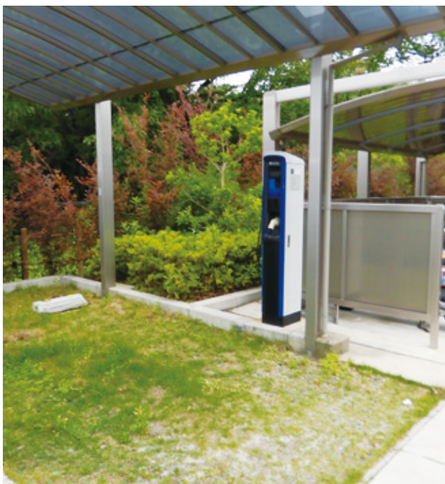
給食センターに設置されている電気自動車充電設備
