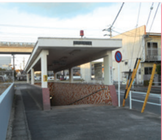
通報装置の取り付けが急がれる地下道
