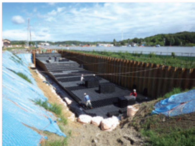
想定外の地下水の流入があった1号調整池
