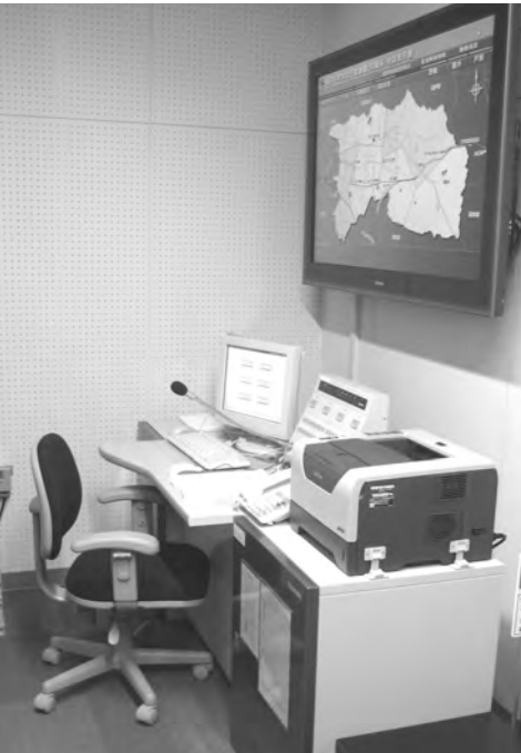
防災の拠点北庁舎の防災行政無線室
