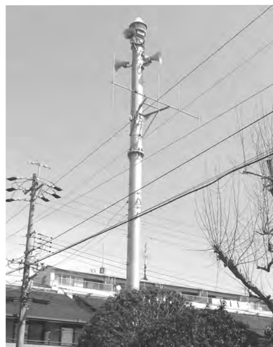
公園に設置された同報系防災無線親局設備1基、拡声子局設備10基を設置
