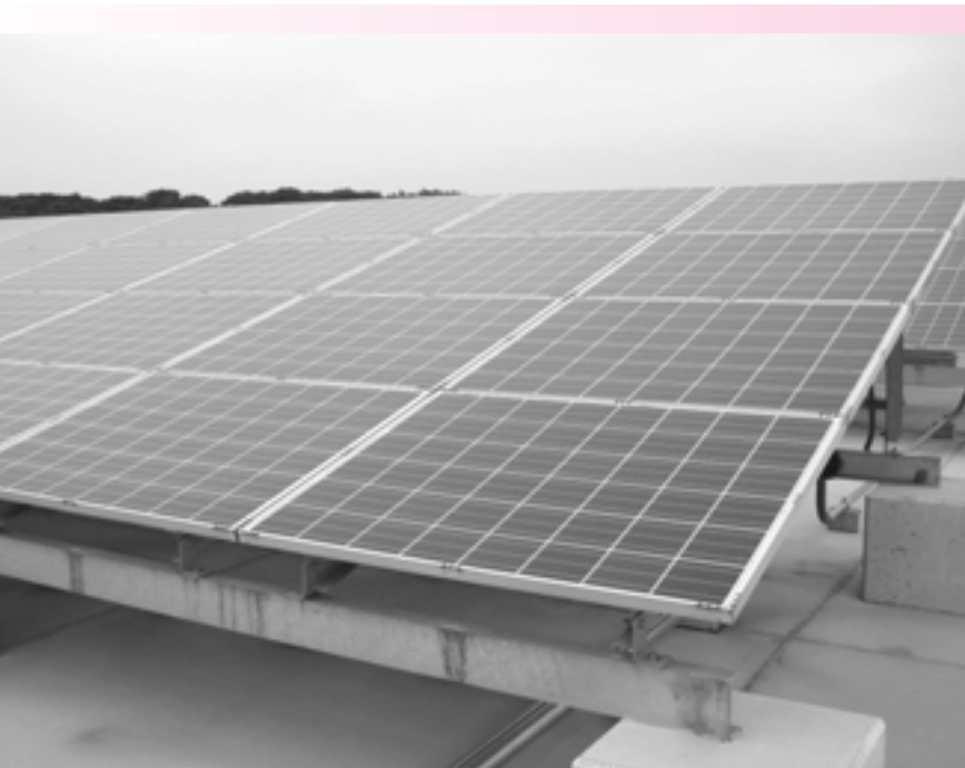
各学校に設置予定の太陽光発電設備(市が洞小学校)
