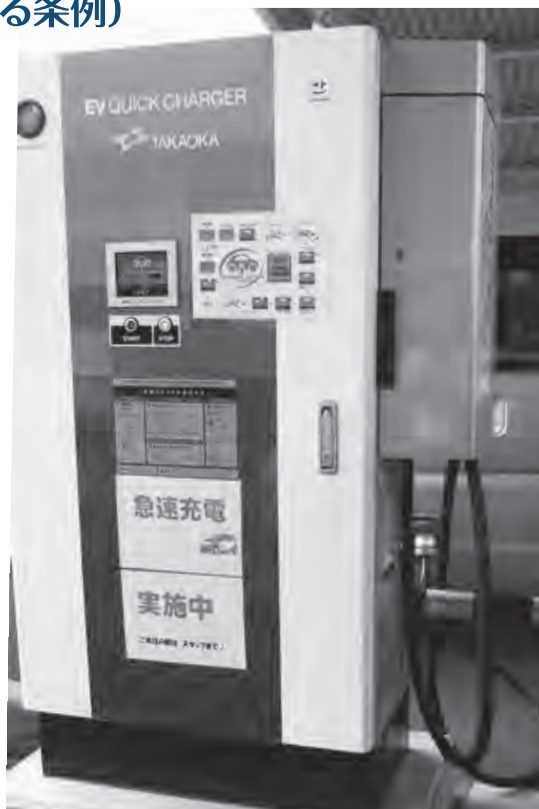
市内に設置されている急速充電設備
