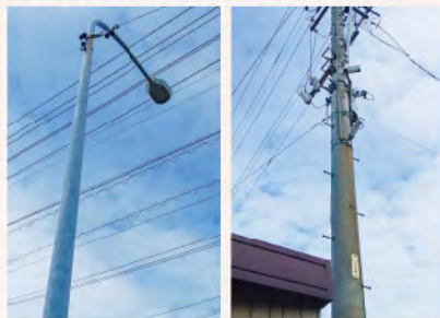
市内の道路照明と防犯灯
