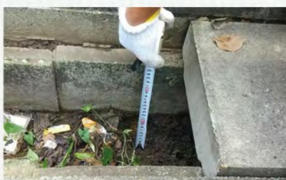
道路側溝に堆積した汚泥
