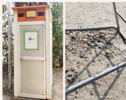
老朽化したトイレと利用者が拾い集めた石ころ
