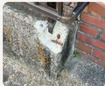
▲建物以外の部分の劣化例
