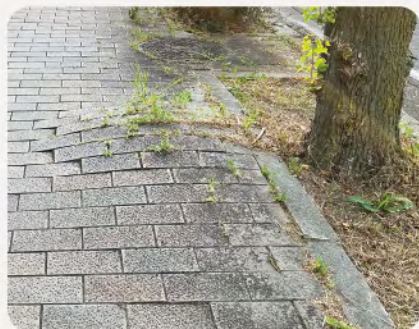
▲樹木の根で歪んだ歩道
