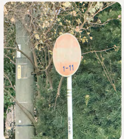
▲色あせた消火栓標識
