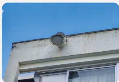
▲定期点検をしている小中学校の音響設備
