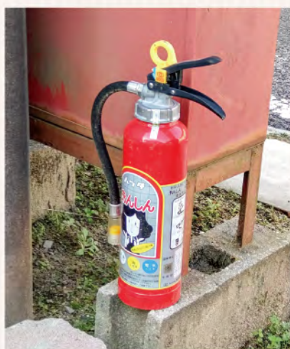
取り扱いが危険な老朽化した加圧式消火器
