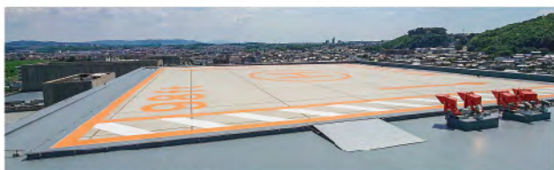
八幡市庁舎屋上ヘリポート
