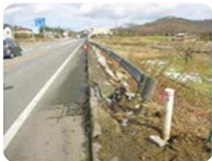
ガードレール・ 標識等の損傷
