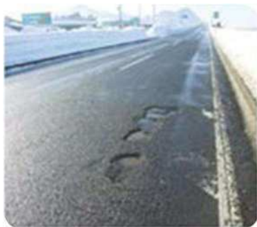
路面の穴ぼこ・ 段差
