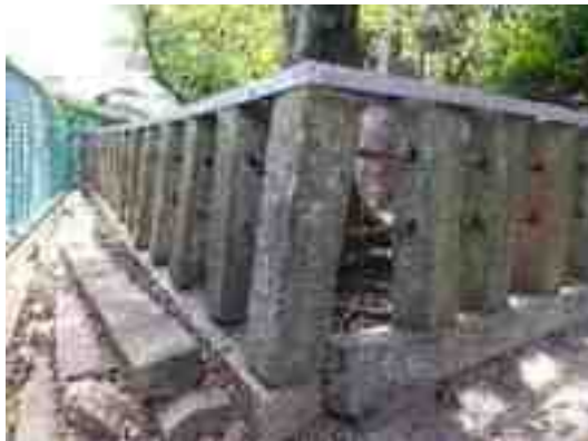
〔北西角〕（石柱はほとんどが歪んでおり、石積笠石のズレも見られる） ・ 左下にある石材は笠石と使われていたもので、保存してある。
