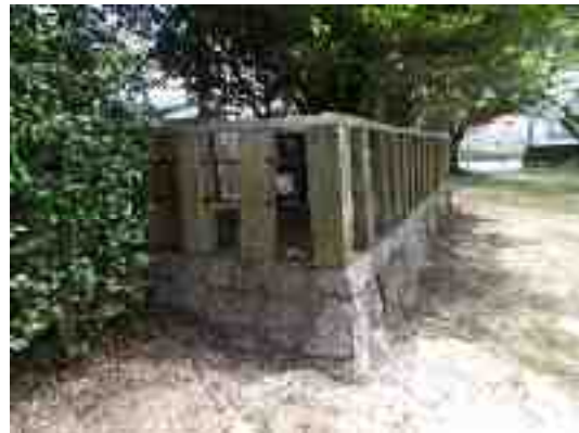
〔南西角〕（南面の石柵は比較的状态は良好。北側は樹木の根の影響で傾きが激しい） ・ 石積は大きな問題は見られないが、角石にズレがある。
