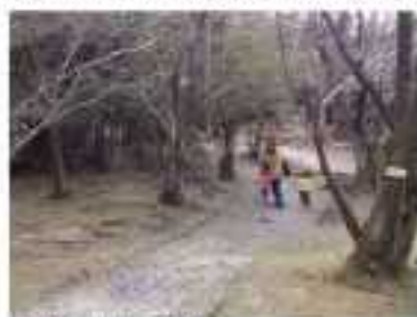
砂利道化した舗装
