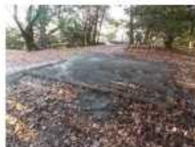
[13 コンクリート舗装 (アスレチック遊具跡)]
