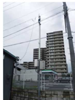
河川カメラの設置状況
